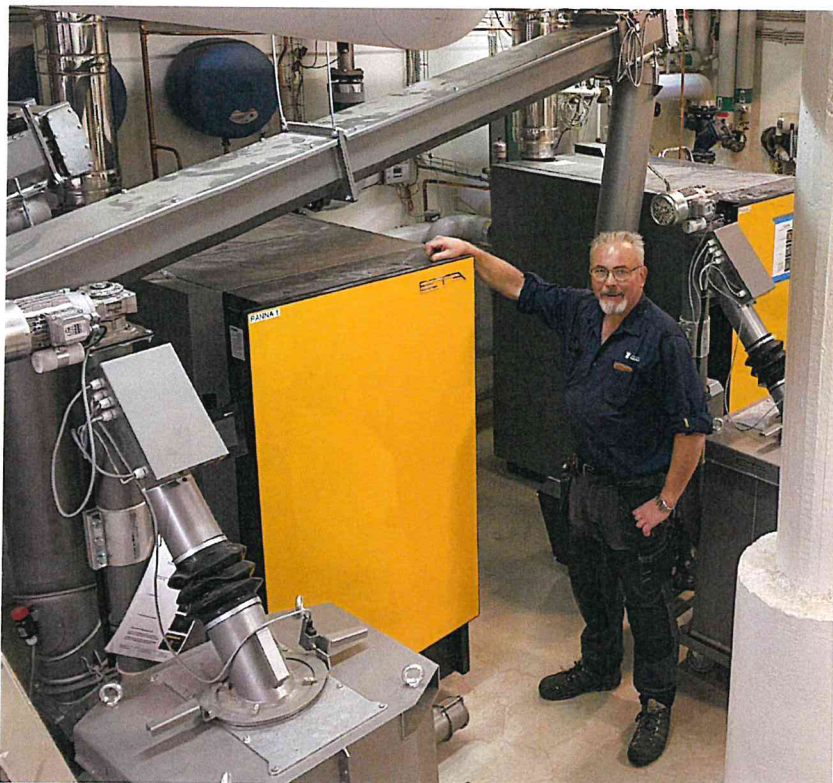
Bild: Fastighetsskötare Glenn Nedergård vid de två flispannorna vid Folkhögskolan.
