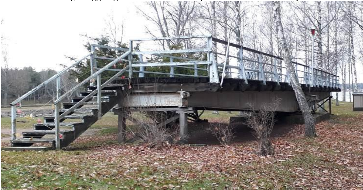
Figur 21: Lemströms gamla kanalbro från nordöst. Brolocket står uppställt som en terrass på kanalområdets nordvästra del.
